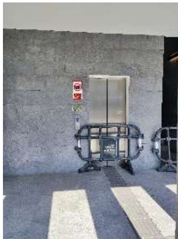
Ilustración 44 Elevador fuera de funcionamiento.
