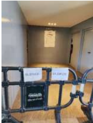
Ilustración 46 Sanitarios fuera de servicio.
